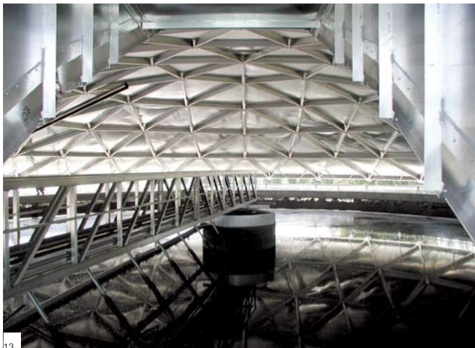
13. Vista interna della vasca di sedimentazione del depuratore di Bastia. Foto di Marcello Togni
