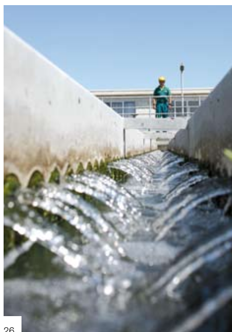
26. Impianto di depurazione acqua
