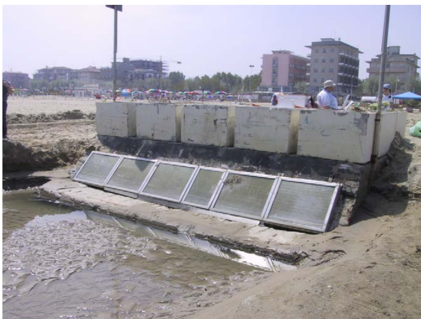
Figura 7.1.2– Paratoie a clapet allo sbocco su una fossa consortile
