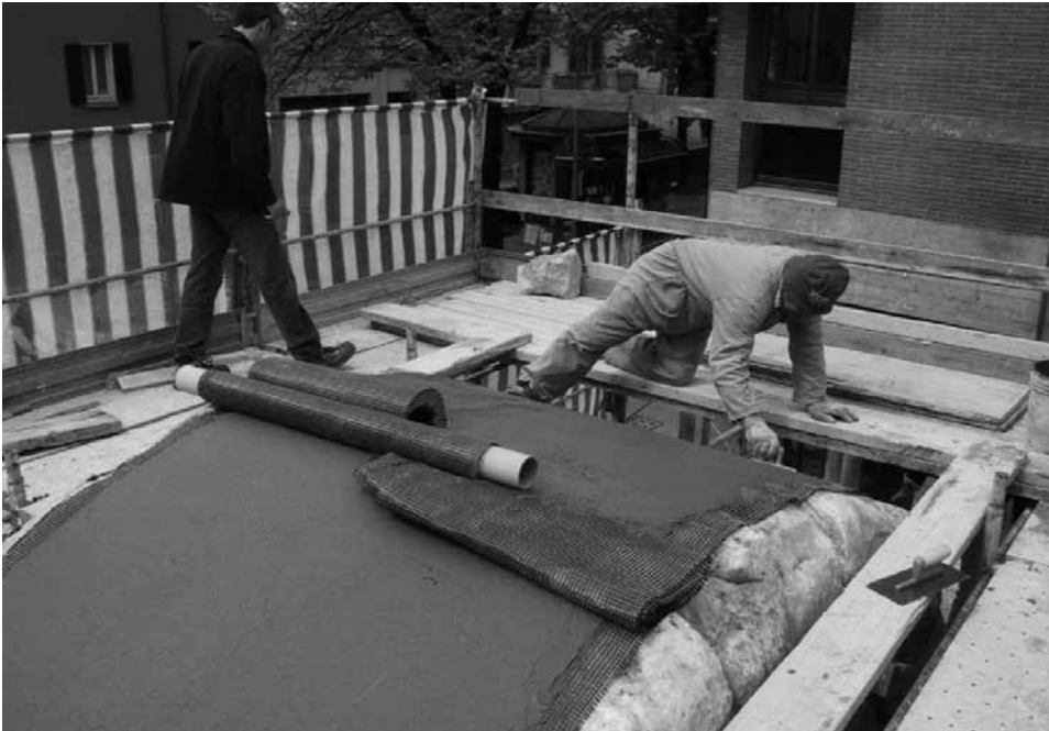
fig. 14 - rinforzo strutturale con CFRP: particolare della posa del secondo foglio all'estradosso della volta.
