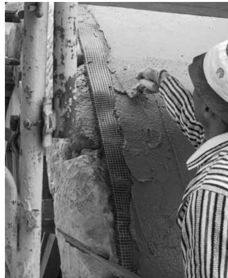
fig. 13 - Rinforzo strutturale con CFRP: primo strato di malta allo estradosso della volta.
